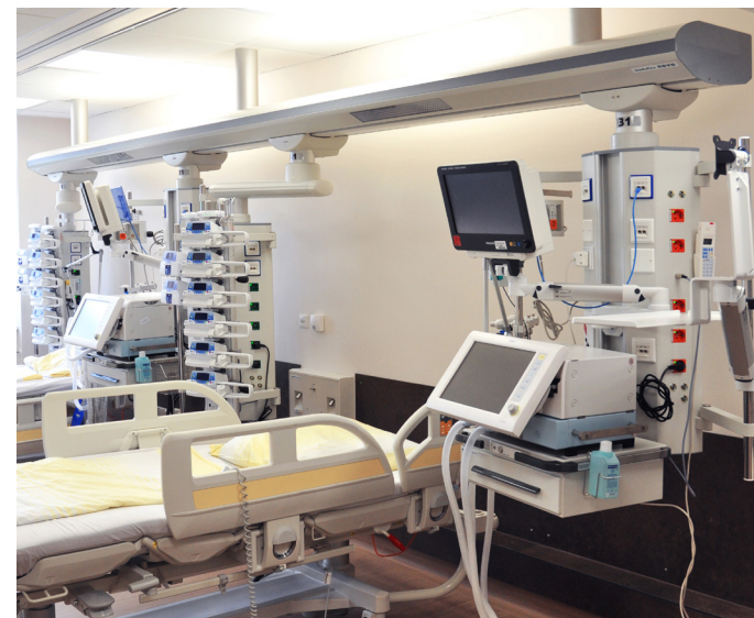
fig. 072 | moduflex nova, BSP 2500 centralised St. Vincenz-Krankenhaus, Limburg
